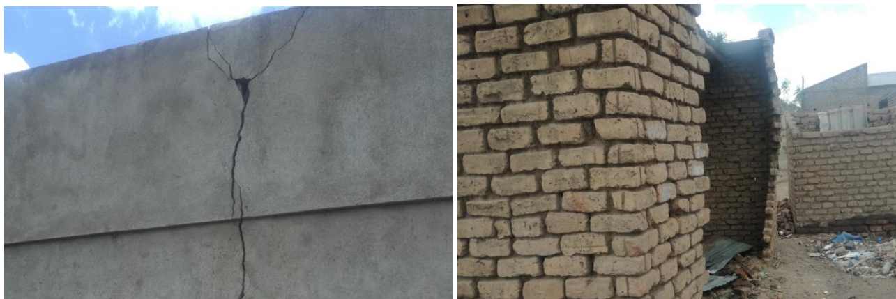
Fotos 4 e 5. Casa com racha e outra de construção precária parcialmente destruída (devido a vibrações de acordo com os proprietários), decorrentes dos estrondos de dinamites no processo de exploração de carvão no Bairro Bagamoio
